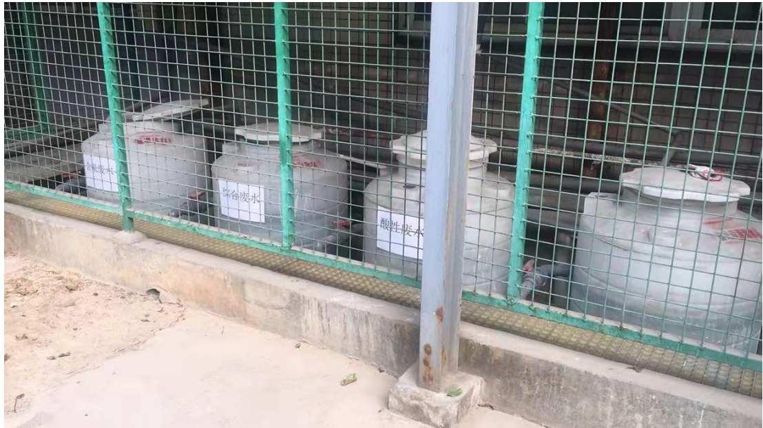
图 7.1-2 废水分类收集罐照片
